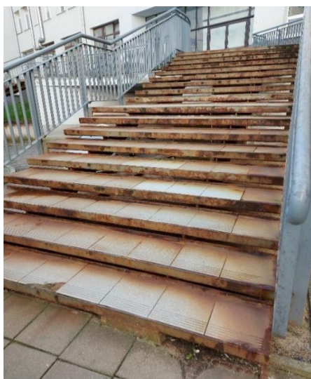
Zdjęcie nr 7. Zniszczone schody do Izby Przyjęć i SOR
