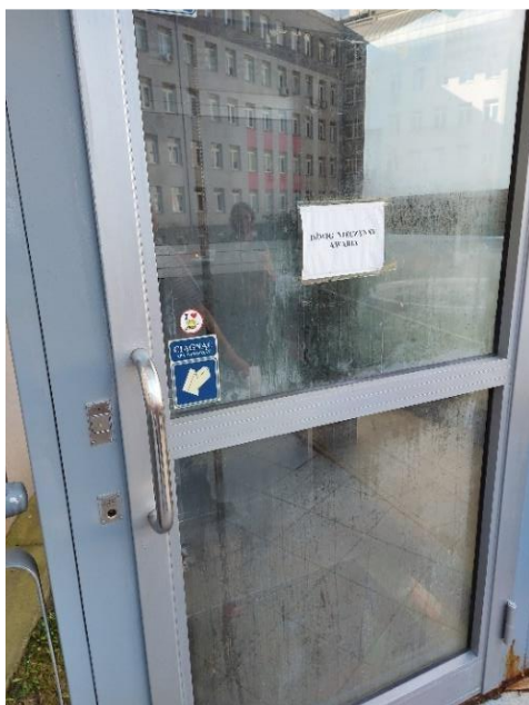
Zdjęcie nr 5. Nieczynny dźwig osobowy
