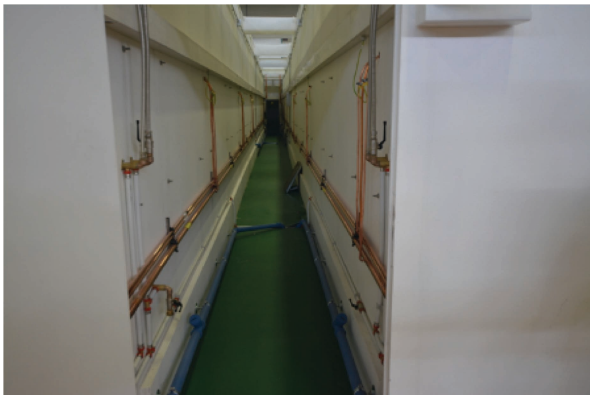
Rycina 9. Doprowadzenia tlenu, powietrza i próżni w kanale serwisowym pomiędzy modułami i stanowiskami intensywnej terapii.
